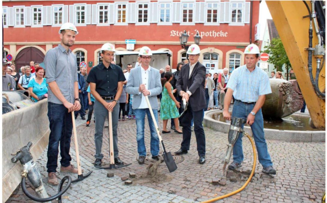
Beim Spatenstich zur Pflastersanierung in der Innenstadt (v. r.) Peter Knoll, Cornelius Bamberger, Reiner Haug, Volker Martin und Philipp Jännsch.
