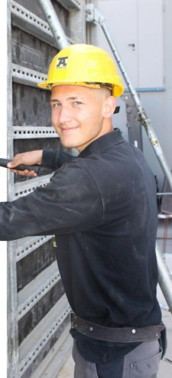
Noel sorgt dafür, dass die Gussform für die Betonwand hält. Foto: Christoph Kraft
