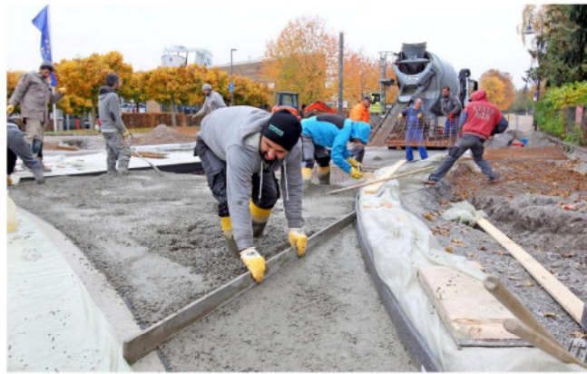
Das geht nur, wenn es nicht regnet: In der vergangenen Woche wurde der Kreisverkehr beim Bürgerzentrum betoniert. Die Verkehrsfreigabe ist für die zweite Dezemberwoche geplant. Fotos: Andreas Veigel
