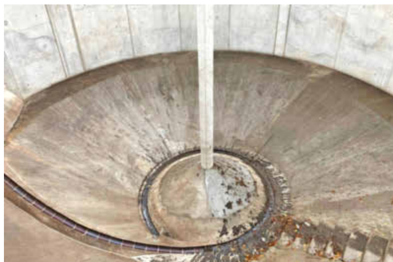
Das „RÜB neu“ ist nicht nur größer als sein Vorgänger, sondern verfügt über einen strudelförmigen Ablauf.
