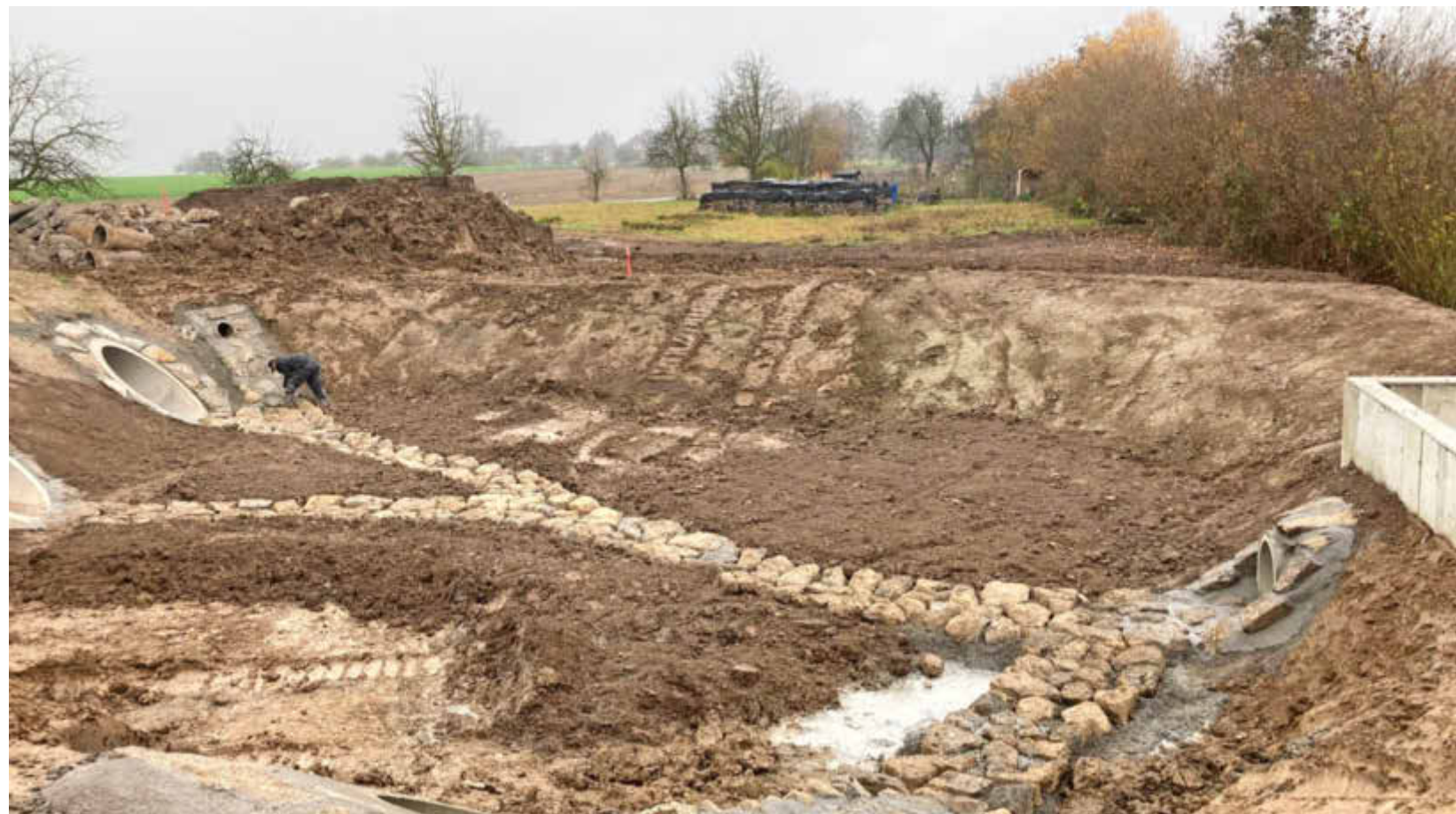
Das Überlaufwerk ist so gut wie fertig. Die Gestaltung ist naturnah erfolgt, am Rand sollen noch Pflanzen gesetzt werden.
