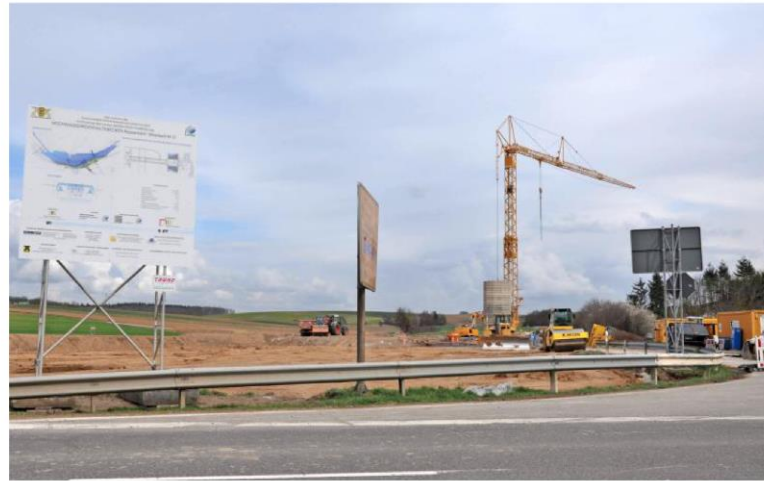
Großbaustelle zwischen Massenbachhausen und Massenbach: Momentan läuft noch alles nach Plan, trotz Corona.
